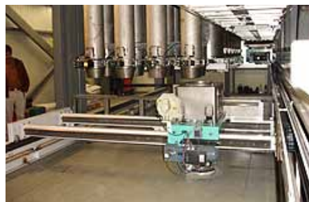
Die Kleinkomponenten-Dosieranlage wird ab November zur Verfügung stehen.
